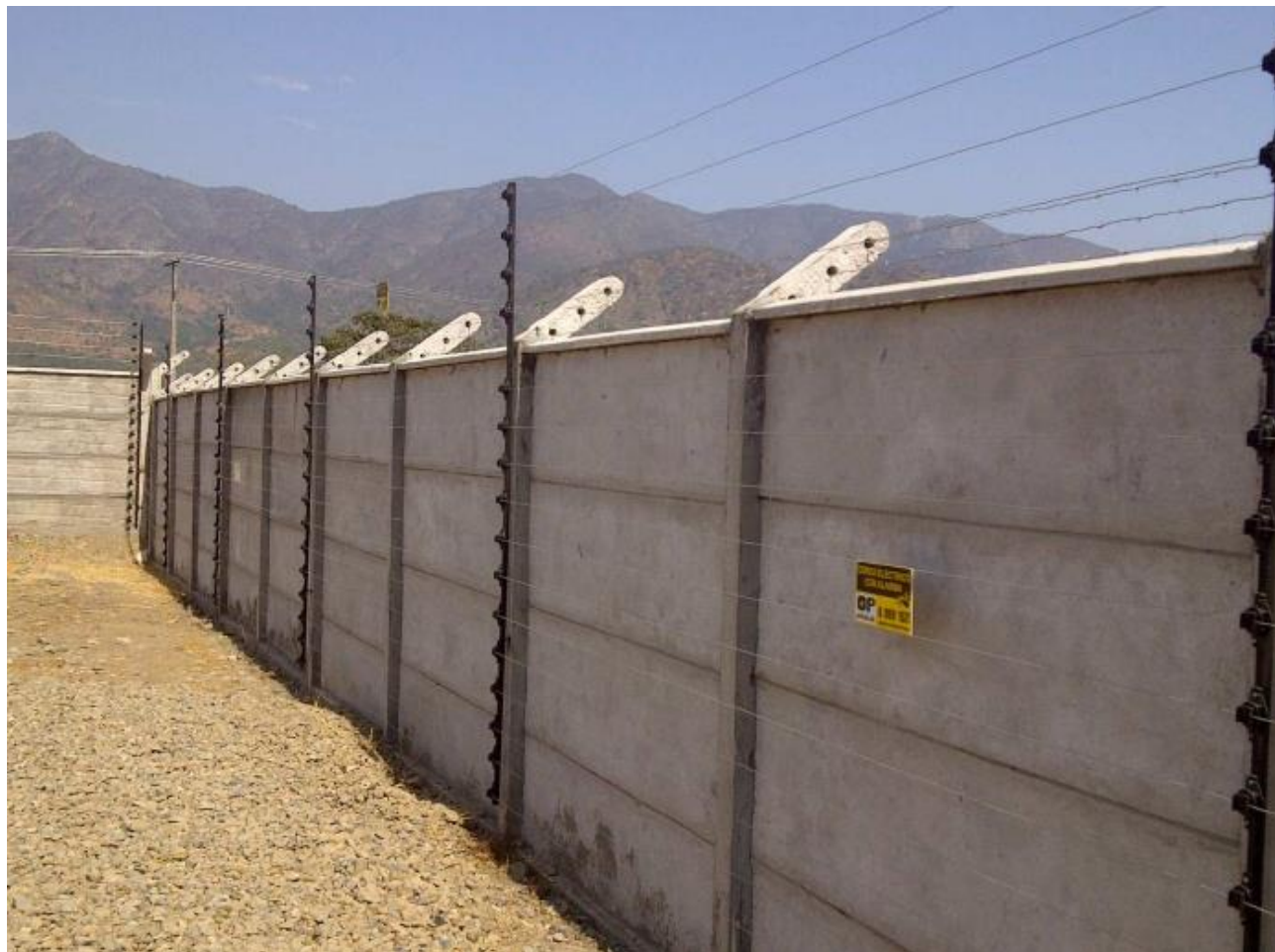
Figura 1.- Cercos Eléctricos en muro perimetral
